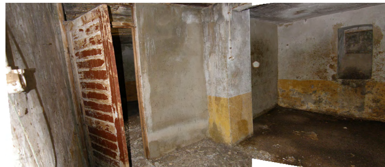
3 - מבט לעבר המחיצה שמפרידה בין חדר A ו-B, אפשר להבחין בעמוד, משמאל דלת שמובילה לחדר A
