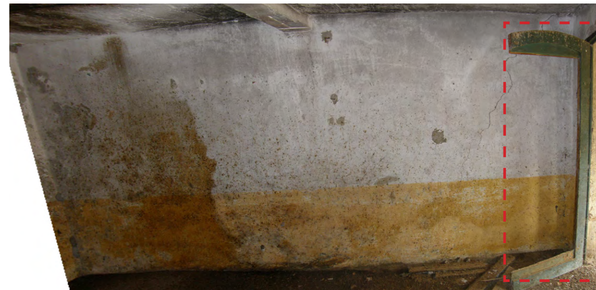
1 - מבט לעבר הדופן הצפון מזרחית שמפרידה בין חדר B ו-C. מימין: דלת הכניסה לחדר
